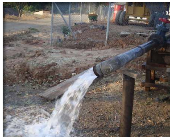
Caudal de rendimiento del pozo
