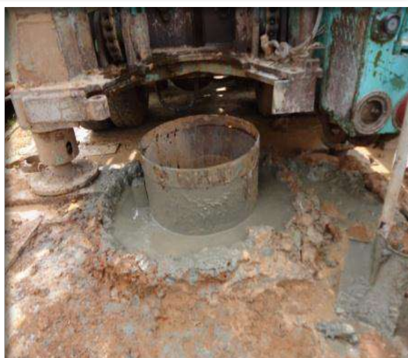
Sellado sanitario del pozo tubular
