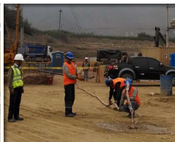
Caudal de rendimiento del pozo
